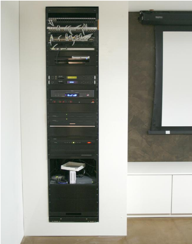
Umfangreiche Medien- und Steuerungstechnik perfekt installiert: Ausziehbares Wandeinbaurack von Middle Atlantic
