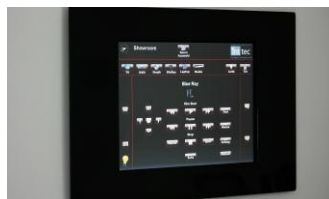
Mehrere AVIT Touchpanels als Bedienstellen
